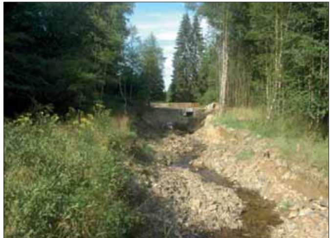
Anlage eines Umgehungsgerinnes und Ersatz einer Verrohrung durch eine Brücke am oberen Wüstabach.
