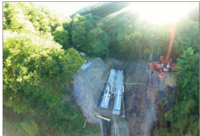
Am Böttenbach wird eine Brücke mit einem großen Kran in die K7 gesetzt.
