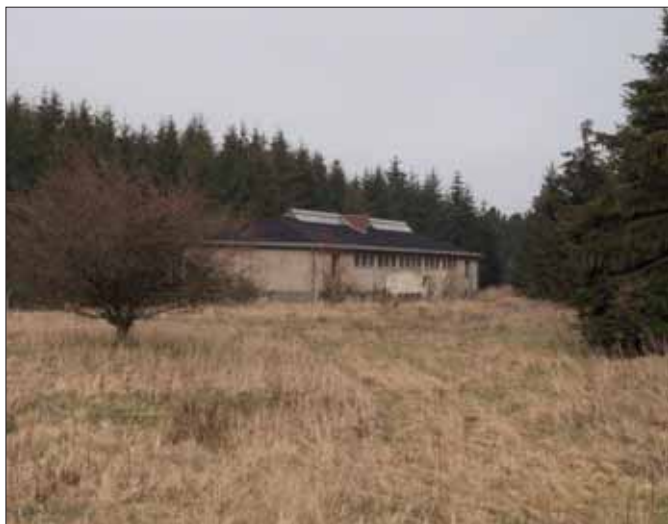
Das ehemalige Badehaus des ehemaligen Truppenübungsplatzes Vogel-sang in der Nähe des Walberhofes stand 2017 noch als Bauruine.
