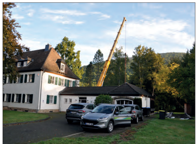
Der Altbau des ehemaligen Nationalparkforstamtes kann aus wirtschaftlichen Gründen nicht mehr durch Sanierung gerettet werden.
