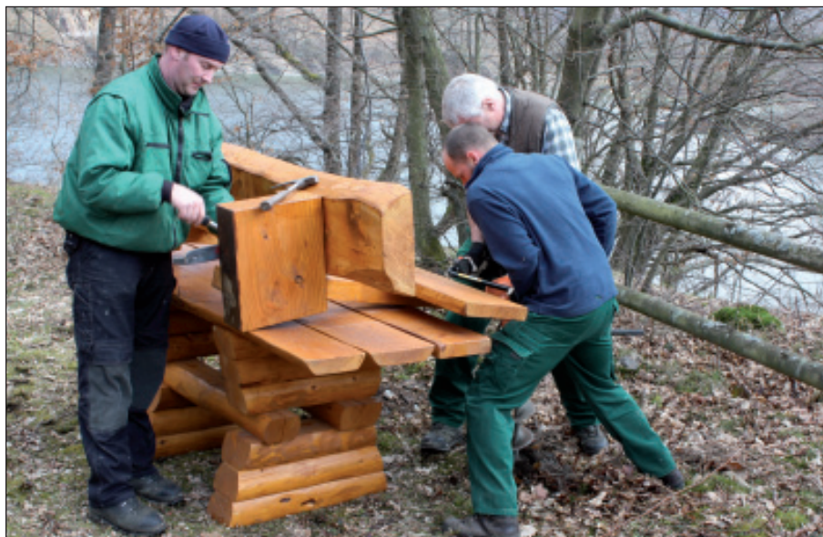
Rechtzeitig zur Saison: die Ranger aus der Holzbauwerkstatt bauen Bänke und Tische an die Wanderwege, hier (von links) Clemens Scory, Harald Grieff und Jan van der Sant am Uruferrandweg (K7).
