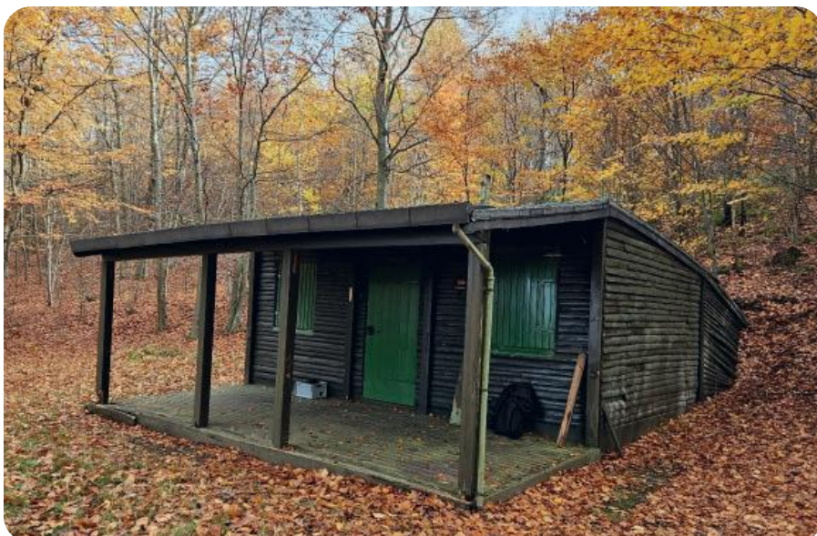
Die baufällige Jagdhütte bei Eicherscheid vor dem Rückbau im Dezember 2025. (Foto: S. Flinkerbusch)
