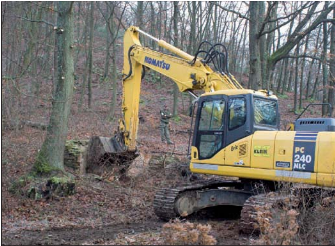
Erste Baggerarbeiten an der Brückenbaustelle auf der Kermeter-Seite, die nach Vereinbarungen zwischen dem Kreis Euskirchen und den Umweltverbänden bis Anfang März 2009 unterbrochen wurden.
