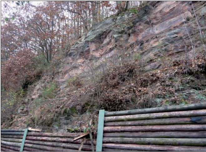
Ein großes Stück Fels löste sich aus der Wand und beschädigte den Pallisadenrand am Urftuferrandweg (Kreisstraße 7).
